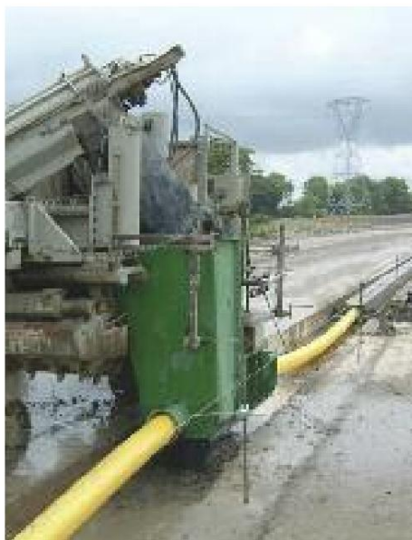
Drenaje ranurado en Uzbekistán que muestra un tubo inflado.
