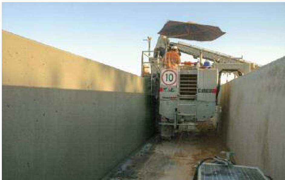
Canal en Australia, base de 3,8 m (12' 5,5") de ancho y lados de 2,1 m (6' 10") de alto. (Se muestra con cinta transportadora personalizada)
